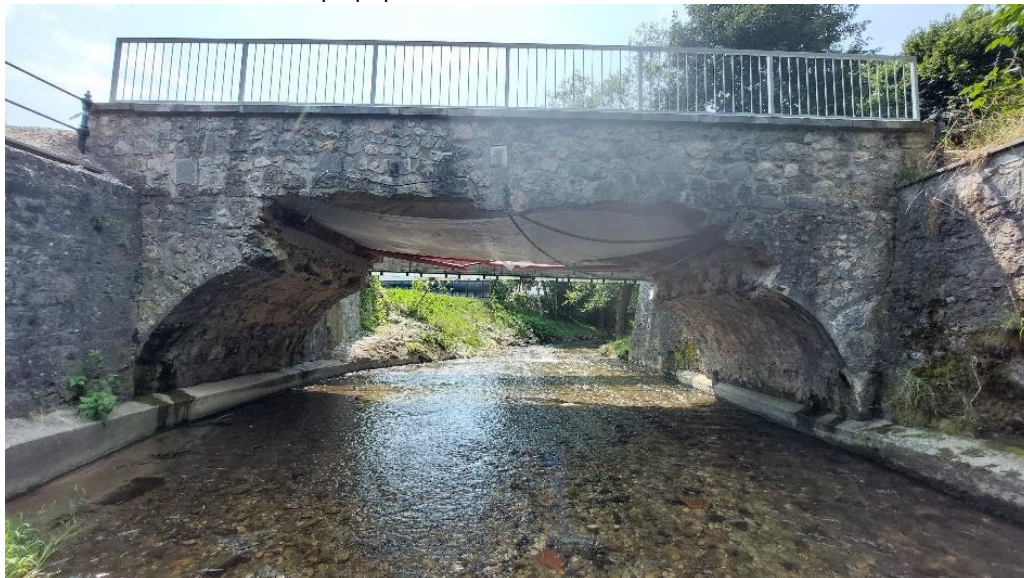
Slika 2.2: Prikaz mostu po poplavih
